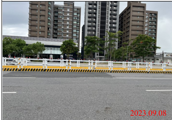
巡查日期地點：112.09.08/ Y23車站 照片說明：路面龜裂狀況
