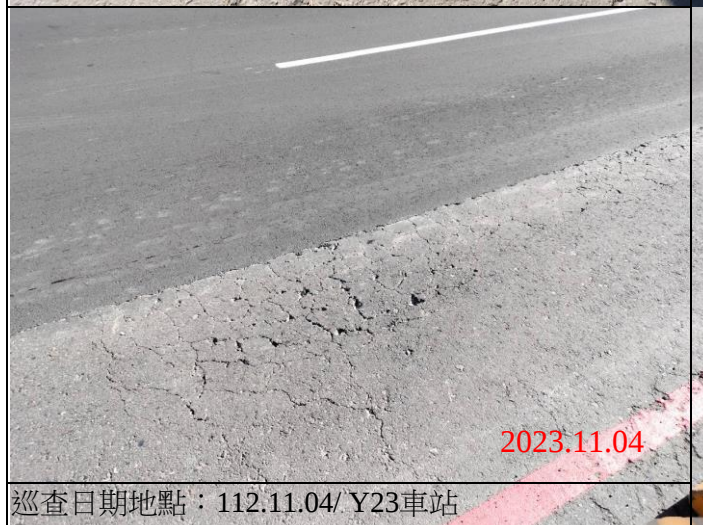
巡查日期地點：112.11.04/ Y23車站 照片說明：路面龜裂狀況
