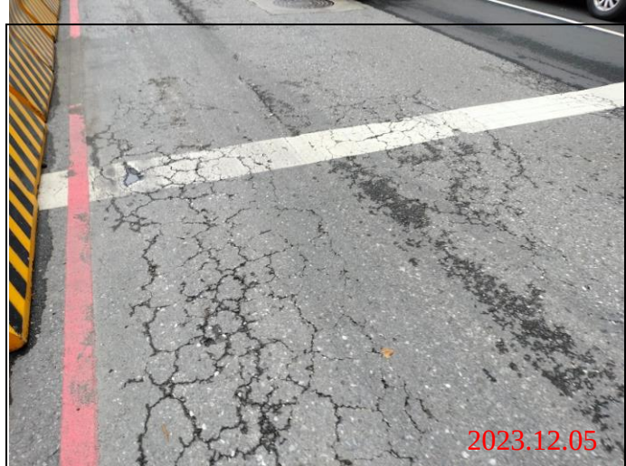
巡查日期地點：112.12.05/ Y23車站 照片說明：路面龜裂狀況
