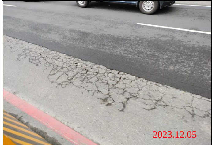
巡查日期地點：112.12.05/ Y23車站 照片說明：路面龜裂狀況
