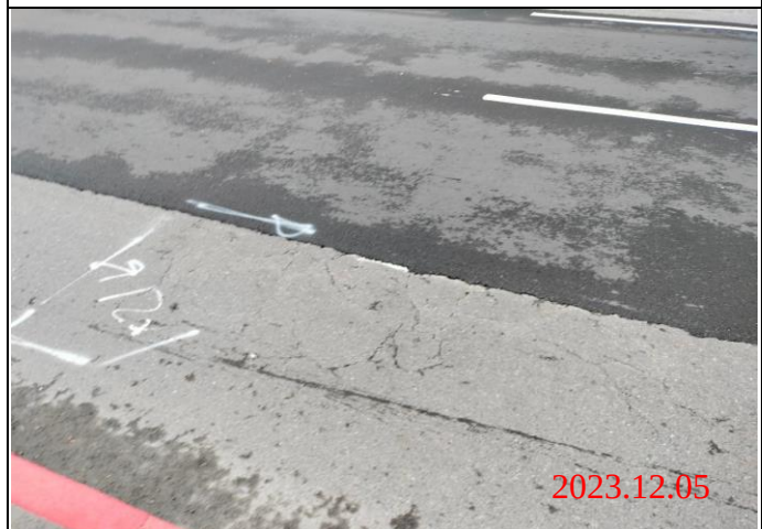
巡查日期地點：112.12.05/ Y23車站 照片說明：路面龜裂狀況
