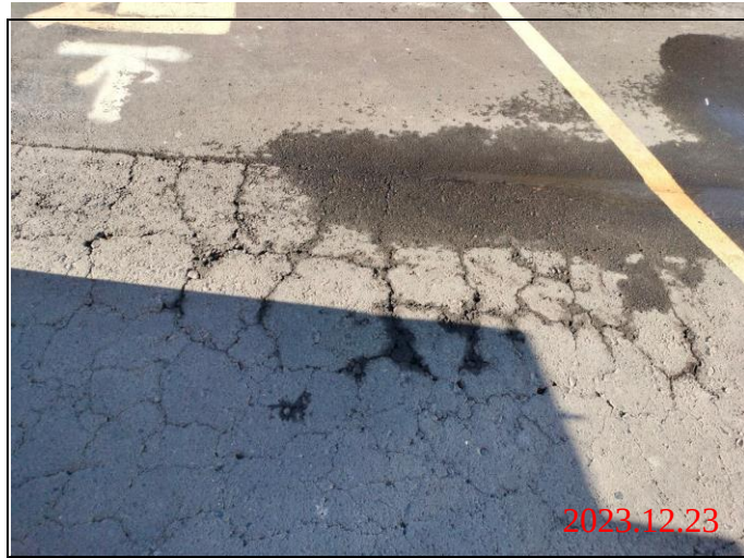
巡查日期地點：112.12.23/ Y23車站 照片說明：路面龜裂狀況
