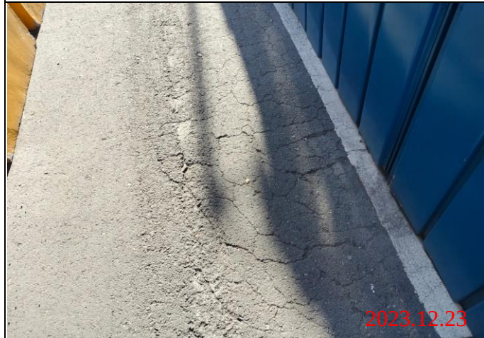
巡查日期地點：112.12.23/ Y23車站 照片說明：路面龜裂狀況
