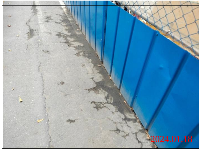
巡查日期地點：113.01.18/ Y23車站 照片說明：路面龜裂狀況
