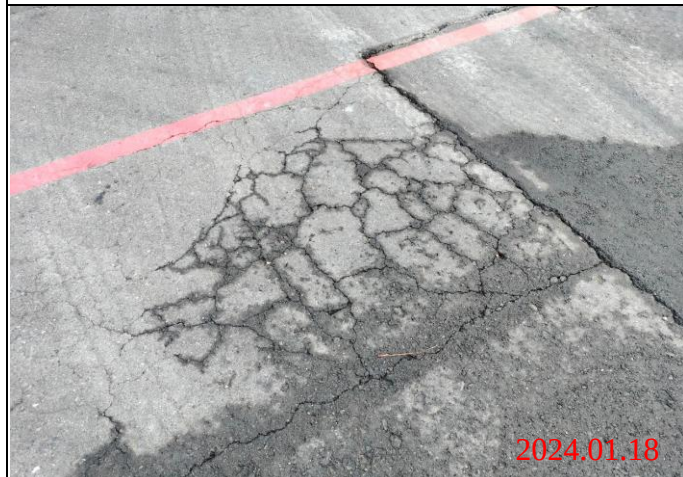
巡查日期地點：113.01.18/ Y23車站 照片說明：路面龜裂狀況
