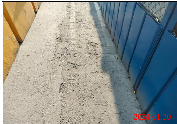
巡查日期地點：113.01.20/ Y23車站 照片說明：路面龜裂狀況
