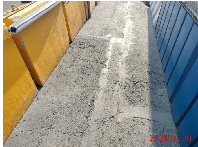
巡查日期地點：113.01.20/ Y23車站 照片說明：路面龜裂狀況
