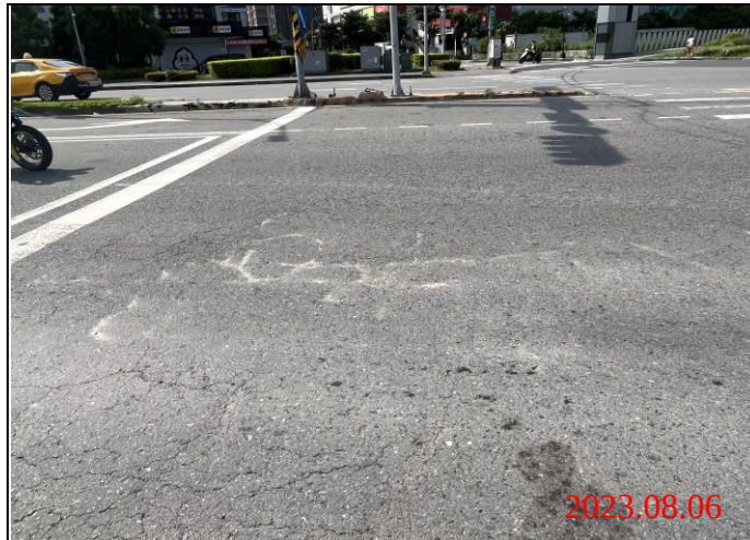
巡查日期地點：112.08.06/ Y22車站 照片說明：路面龜裂狀況
