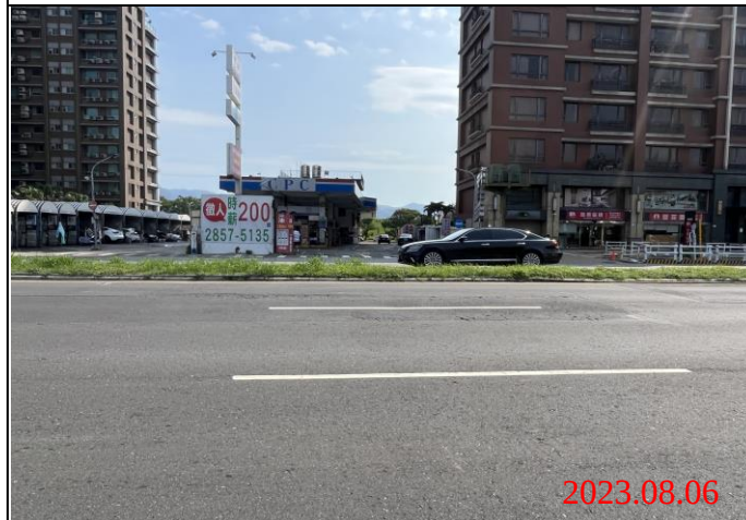
巡查日期地點：112.08.06/ Y23車站 照片說明：路面龜裂狀況
