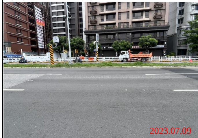
巡查日期地點：112.07.09/ Y23車站 照片說明：路面龜裂狀況
