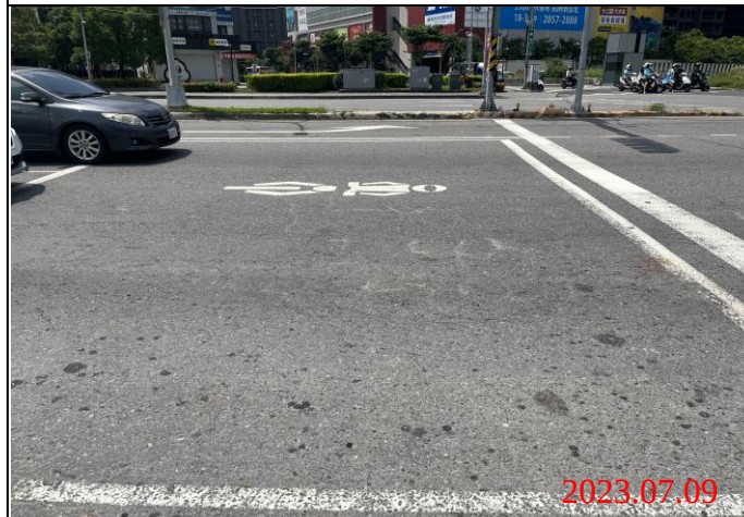
巡查日期地點：112.07.09/ Y22車站 照片說明：路面龜裂狀況
