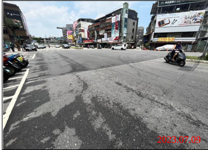
巡查日期地點：112.07.09/ Y21車站 照片說明：路面龜裂狀況
