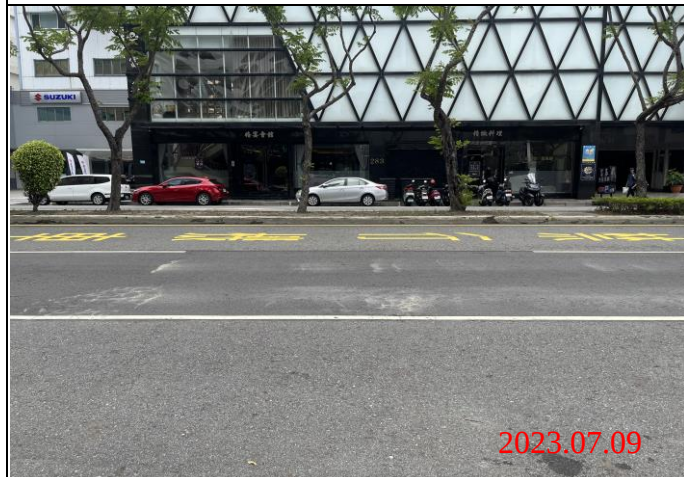
巡查日期地點：112.07.09/ Y21車站 照片說明：路面龜裂狀況
