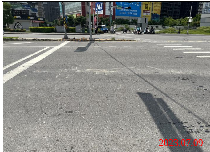
巡查日期地點：112.07.09/ Y22車站 照片說明：路面龜裂狀況
