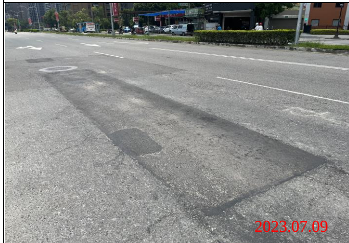
巡查日期地點：112.07.09/ Y2車站 照片說明：路面龜裂狀況
