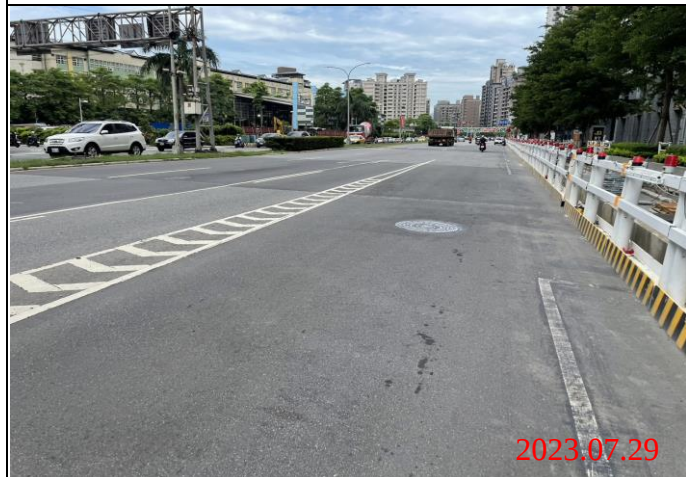
巡查日期地點：112.07.29/ Y23車站 照片說明：路面龜裂狀況
