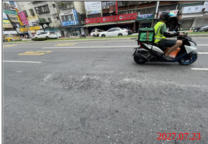
巡查日期地點：112.07.29/ Y21車站 照片說明：路面龜裂狀況
