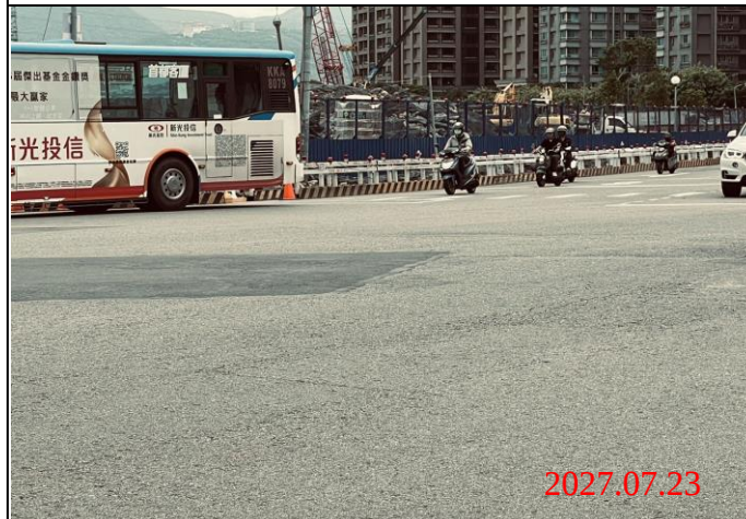
巡查日期地點：112.07.29/ Y22車站 照片說明：路面龜裂狀況
