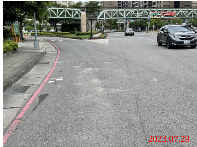
巡查日期地點：112.07.29/ Y23車站 照片說明：路面龜裂狀況
