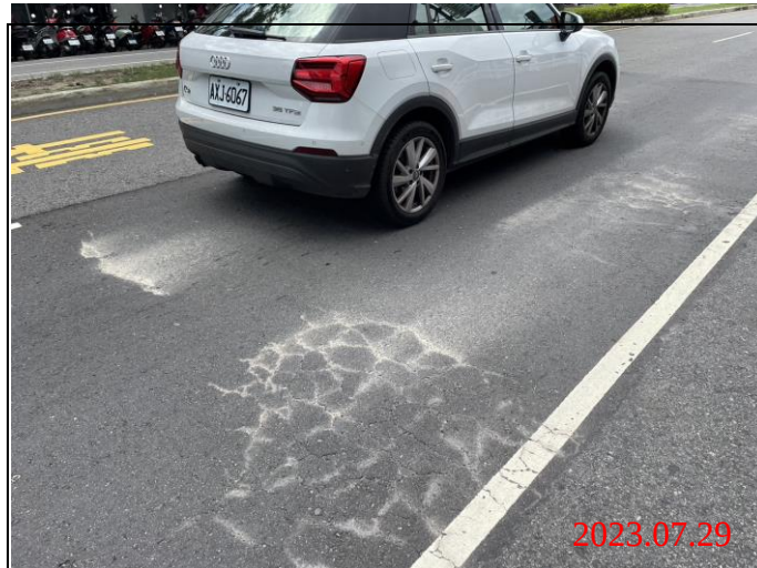
巡查日期地點：112.07.29/ Y21車站 照片說明：路面龜裂狀況
