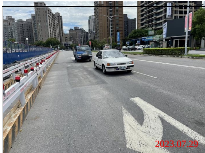
巡查日期地點：112.07.29/ Y22車站 照片說明：路面龜裂狀況
