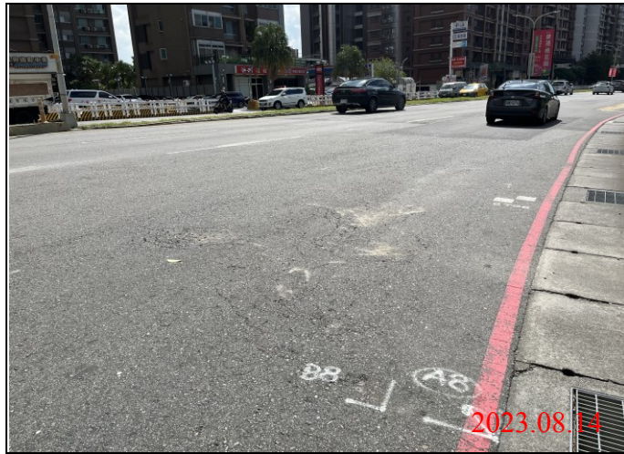
巡查日期地點：112.08.14/ Y23車站 照片說明：路面龜裂狀況
