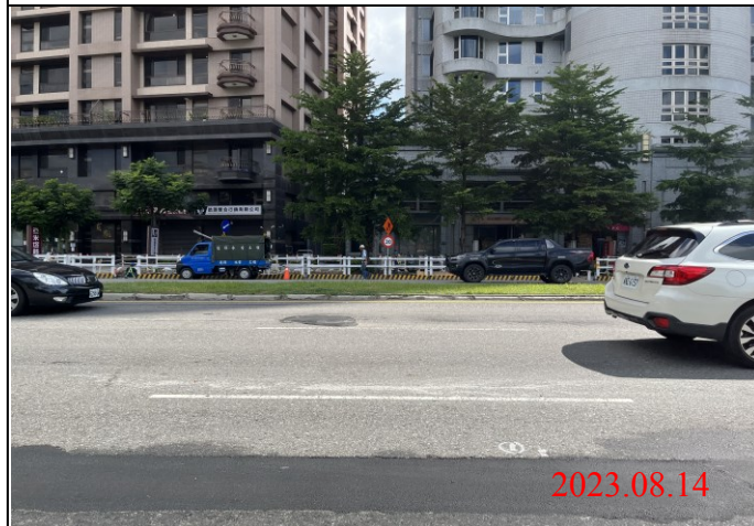
巡查日期地點：112.08.14/ Y23車站 照片說明：路面龜裂狀況
